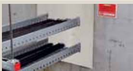
Chemin de câbles, câbles et conduits
