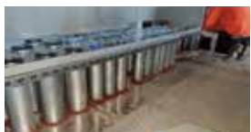
Pénétrations multiples (bancs de colonne montante)
