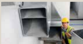
Réseau de gaines de CVC
